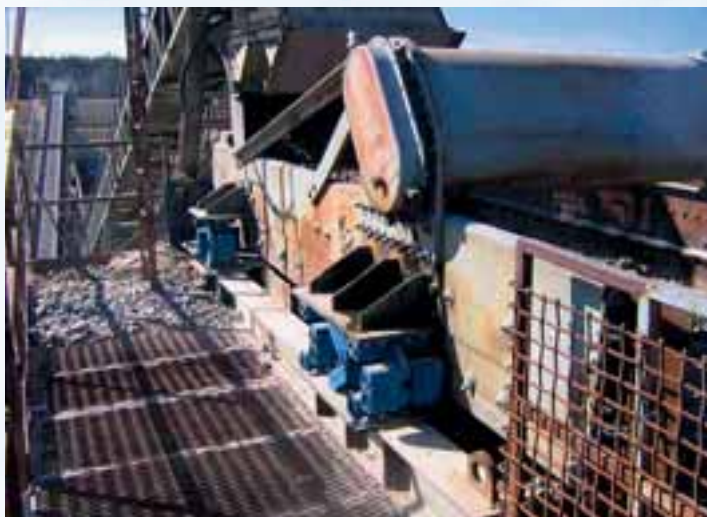
Dewatering screen, aggregate Crible d'asséchage de gravier
